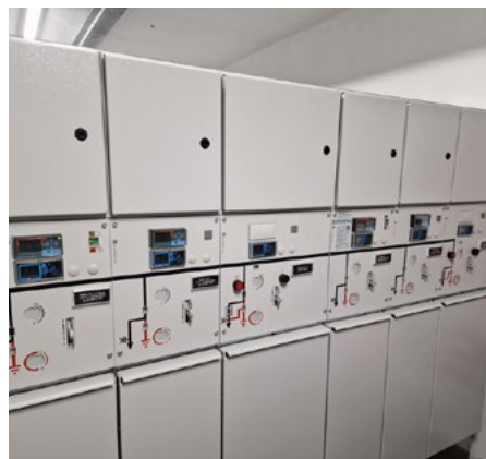
Cellules électriques moyenne tension
